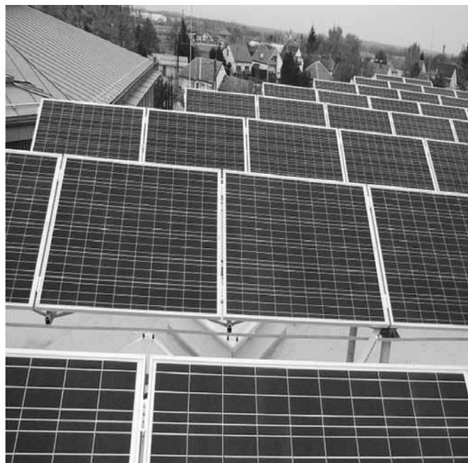
Napelemek a Gyóni Géza Általános Iskola tetőszerkezetén
